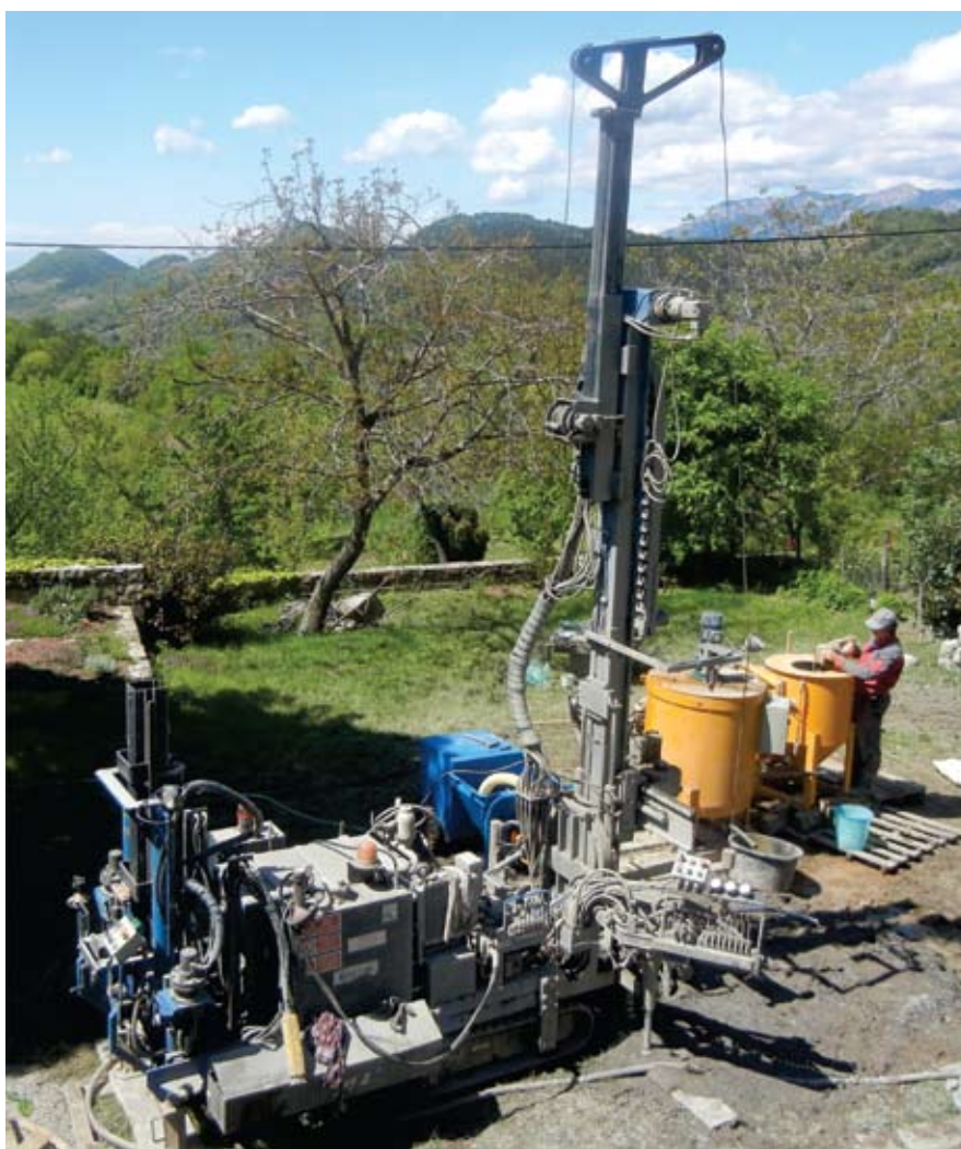
Izvajanje energetskega sistema Enertus na objektu.
